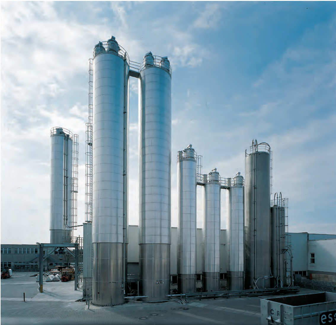
Bild 1: Siloanlage mit Außensilos (AZO GmbH + Co. KG)
