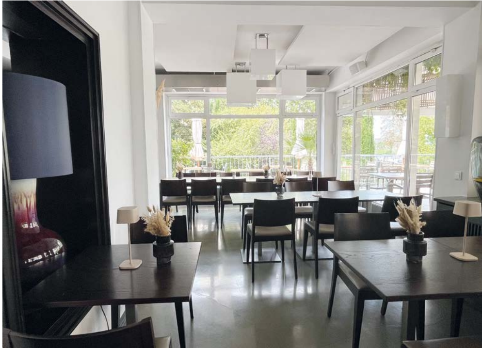
Abbildung 6: Von der Decke abgehängte Faserplatten im Gastraum; Quelle: Bootshaus Mannheim; Foto: Lamprecht
