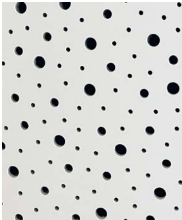
Abbildung 13: gelochter Absorber an der Decke; Foto: Lamprecht
