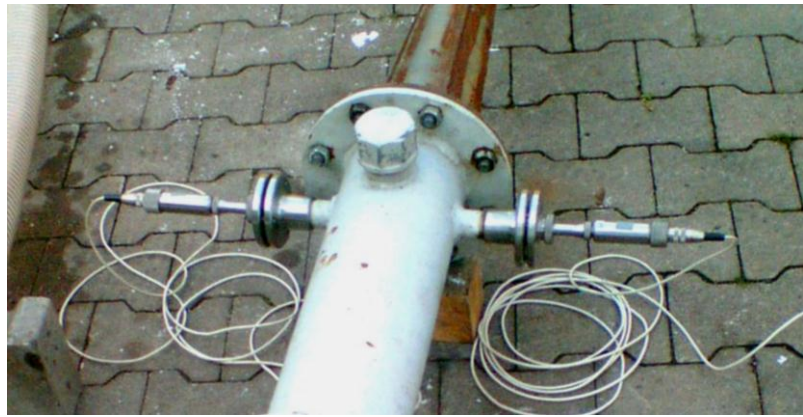
Bild 3: Messeinheit zur Bestimmung und Überwachung der Staubkonzentration in pneumatischen Förderleitungen.
