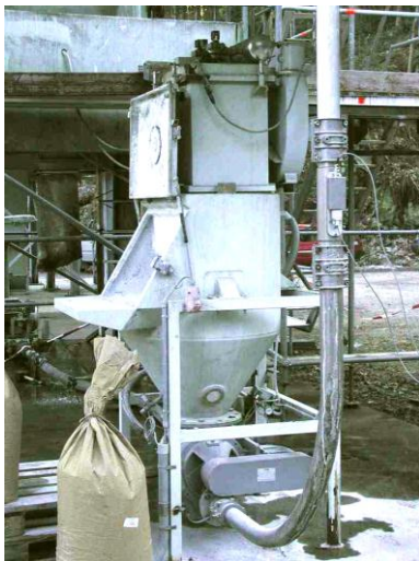
Abbildung 4: Sensorkopf eingebaut in die pneumatische Förderanlage auf dem Versuchsfeld in Kappelrodeck.
