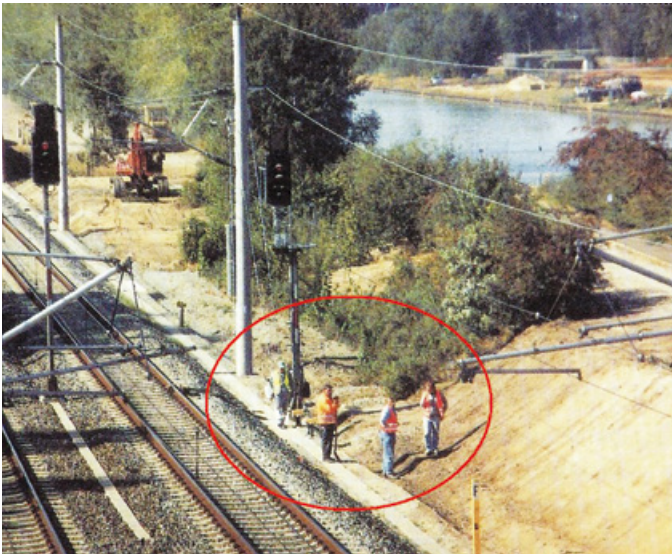
Abbildung 1: Die Beschäftigten arbeiten auf dem Randweg außerhalb des Gleisbereichs. Ob die Gefahr besteht unbeabsichtigt in den Gleisbereich zu gelangen, entscheidet der bauausführende Unternehmer.
