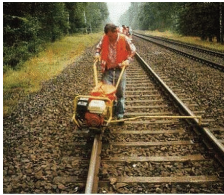
Abb. 4: Es geht auch eine Gefährdung von Fahrten im Nachbargleis aus
