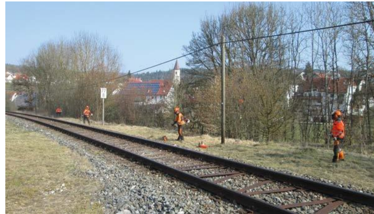
Schnell fortschreitende Vegetation neben dem Gleis: Mit dem Hineingeraten in den Gleisbereich ist im Schutzstreifen zu rechnen.
