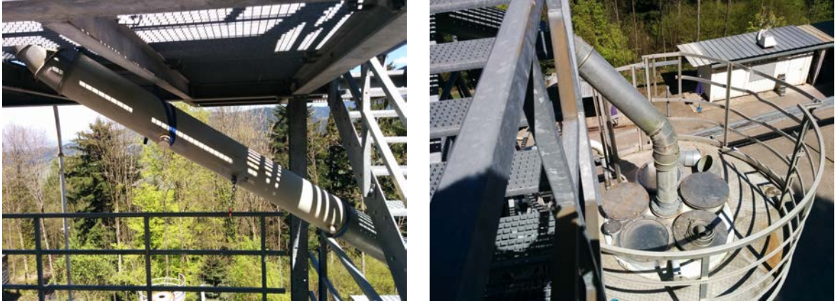
Abbildung 3.2: Fallrohr zwischen Elevatorabwurf und Silokopf.
