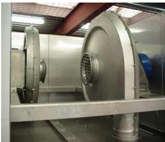
Abb. 24: Ventilatoren auf Waschanlage; Quelle [14]
