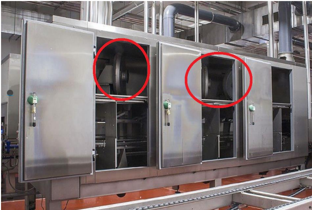
Abbildung 23: Ablaseinheit kaskadierter Radialventilatoren in Einhausung; Quelle: [2]
